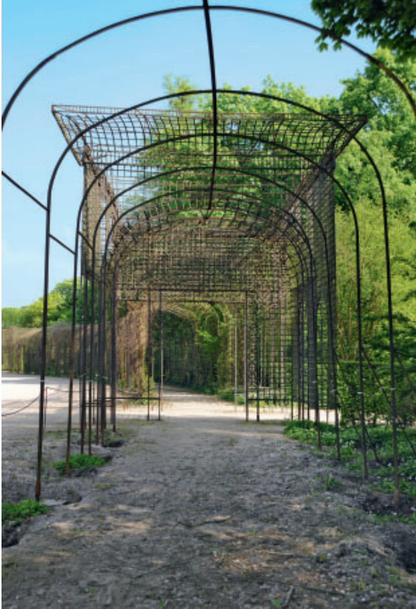
4 Die Gittergrundkonstruktion nach teilweiser Abnahme von Bewuchs und Latten. Deutlich sind die Staunässebereiche der FüÙe mit Grasbewuchs zu erkennen. An diesen Stellen ist vermehrt mit Korrosion zu rechnen.
