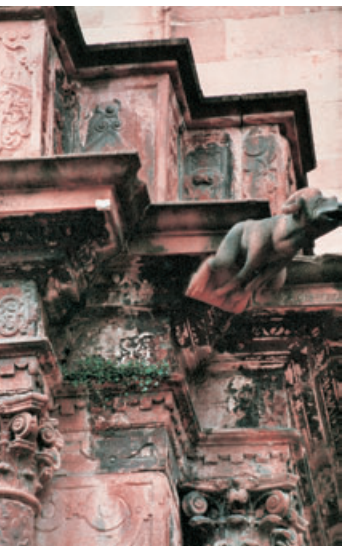
5 Wasserspeier an der Balustrade vor der Restaurierung.
