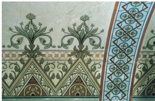
14 Sulzbach/Kocher (Gemeinde Sulzbach-Laufen, Kreis Schwäbisch Hall), evangelische Pfarrkirche (1892/93 restauriert), Dolmetsch-Decke (Detail über der 1963 eingezogenen Decke im Kirchenschiff (Aufnahme 2003).
