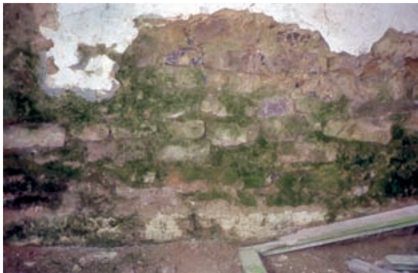
3 Sockelbereich Innenraum, Algenbewuchs, Aufnahme Mai 1994.
