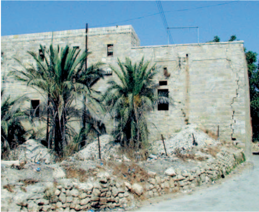
9 Südfassade des zukünftigen „Museum of Memory“. Das rechts befindliche Bauernhaus ist der älteste Teil des Anwesens. Deutlich sind die tiefen Risse in der Fassade des Bauernhauses zu erkennen.
