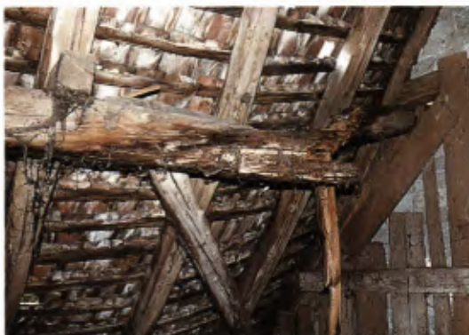
3 Zehntscheuer, Schadensbild des südwestlichen Dachstocks mit gebrochenem Stuhlrähm, 1996.
