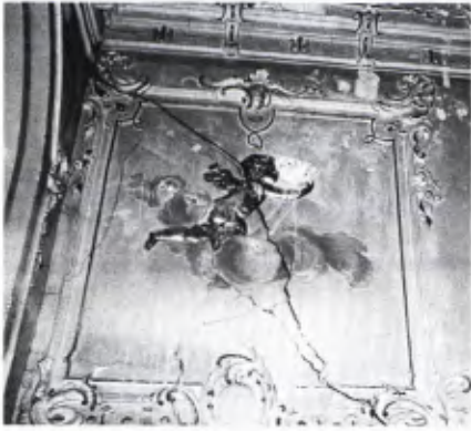
■ 4 Schadensbild über dem Gestühl (1993).
