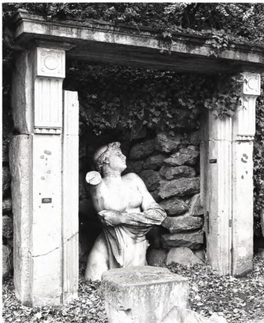
■ 5 Portaleinfassung des Gasthofs „König von England“, Sandstein, 1798, Dorotheenstr. 2 (Inv. Nr. 90). Schadensbild: Risse, statische Probleme. Außerdem zu sehen: Skulptur einer Wiesennympe (Inv. Nr. 91). Foto: Stadtarchiv Stuttgart (J. Weigele).
