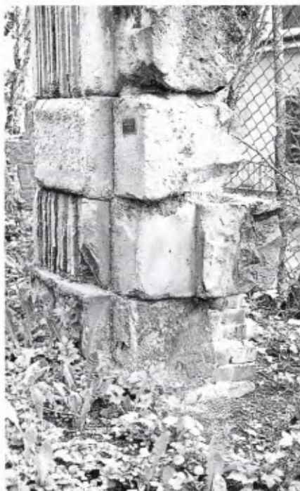
■ 7 Fragment einer Lisene mit Wandstücken vom Neuen Lusthaus, Georg Beer, Sandstein, 1584–1593 (Inv. Nr. 145). Schadensbild: Eingewachsen und mit Erdreich verschüttet. Foto: J. Weigele.
