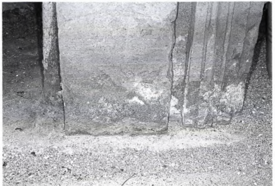
■ 6 Portaleinfassung, Detail. Schadensbild: Abspaltungen von Profilen und Salzausblühungen durch aufsteigende Feuchtigkeit. Foto: J. Weigele.
