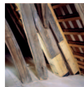
19 Schadensbild der Konstruktion von 1475/76 auf der Nordseite, von Nordwesten. Die Mauerlatten wurden nach der Kirchen-erweiterung von 1963/64 entfernt, die alte Konstruktion mit beigelaschten Hölzern gesichert.
