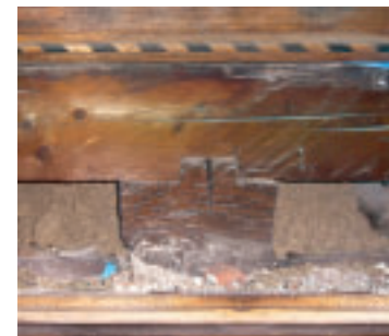
7 Nachträglich beschnittener Deckenbalkenkopf hinter dem (hier ausgebauten) Tafelfries.
