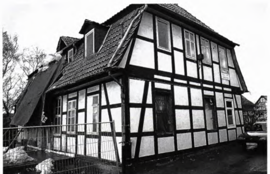
■ 3 Das Gebäude des heutigen Kindergartens von Groß Lengden bei Göttingen während seiner energetischen Sanierung.
