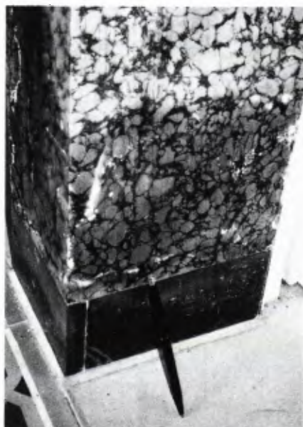
■ 14 Salzausblühungen und Dunkelfärbung des Stuckmarmors im Sockelbereich durch Feuchtigkeit (im Vordergrund Kugelschreiber als Größenvergleich).
