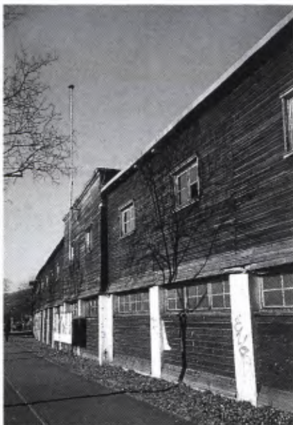
■ 2 Die Holzverkleidung des Strandbads weist starke Schäden auf.
