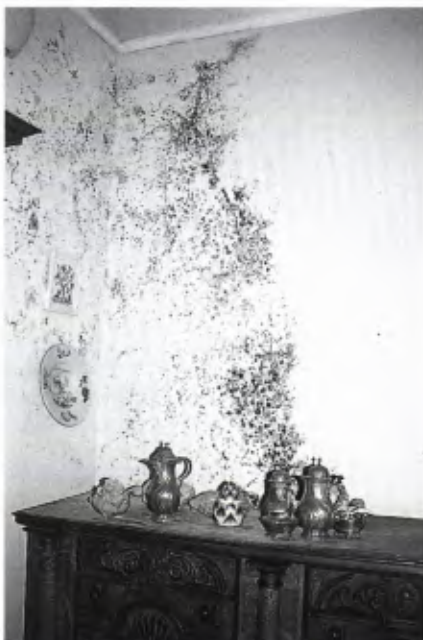
■ 5 Starke Durchfeuchtungen der Außenwand durch falsch angelegte Fallrohröffnung auf dem Dach der Sakristei.
