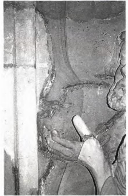
■ 20 Irreversible Verunreinigungen eines Sandsteinreliefs durch ausgetretenes Epoxidharz.
