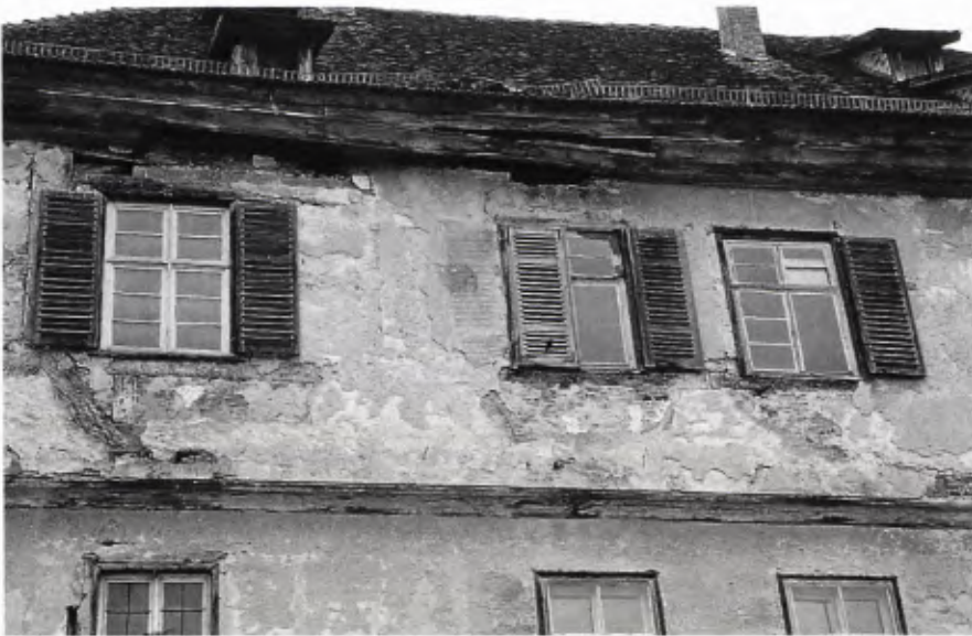
■ 6 Die ausgeprägten Schäden an Außenputz und hölzerner Traufe wurden durch ein undichtes Dach verursacht.
