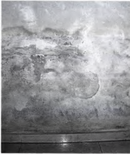
■ 26 Durch aufsteigende Feuchtigkeit verursachte Putzschäden.
