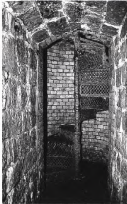
■ 8 Im Abstand von maximal 100 m gibt es Einstiege, die in der Regel mit geradeläufigen Treppen versehen sind. Im Kanal sind sie mit Straßenschildern bezeichnet. Abweichend davon gibt es die sogenannten Sternschächte, deren Deckel aus sternförmig aufgeschnittenen Metallplatten besteht und die über eine Metallwendeltreppe erschlossen sind.
