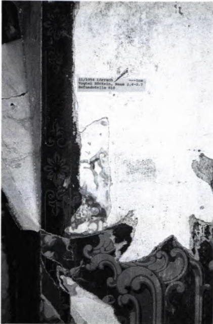
■ 4 Tapetenfragmente an der Wand. „Alte Vogtei“ in Lörrach-Haagen.
