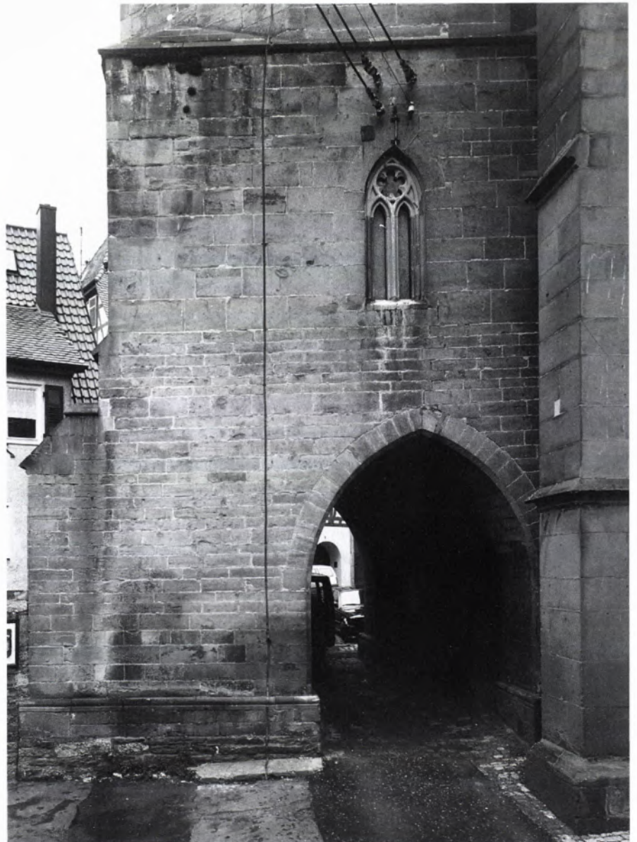
■ 5 Ansicht des unteren Turmbereiches von Süden. Die kleinteiligen Steine werden einer ersten und die größeren einer zweiten Bauphase einer Kapelle vor dem Kirchenneubau von 1513 zugeordnet. Der Riß über dem Spitzbogen der Durchfahrt zeugt von den Spannungen im Mauerwerk, verursacht durch die Turmneigung nach Westen. Photogrammetrische Aufnahme September 1991.
