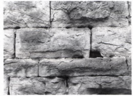
■ 17 Unterer Bergfried, Schadensbild. Foto 1996, LDA.
