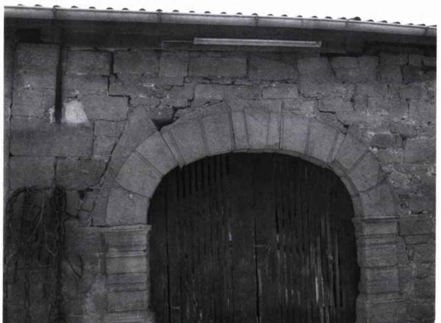
■ 16 Barockportal, Schadensbild. Foto 1996, LDA.
