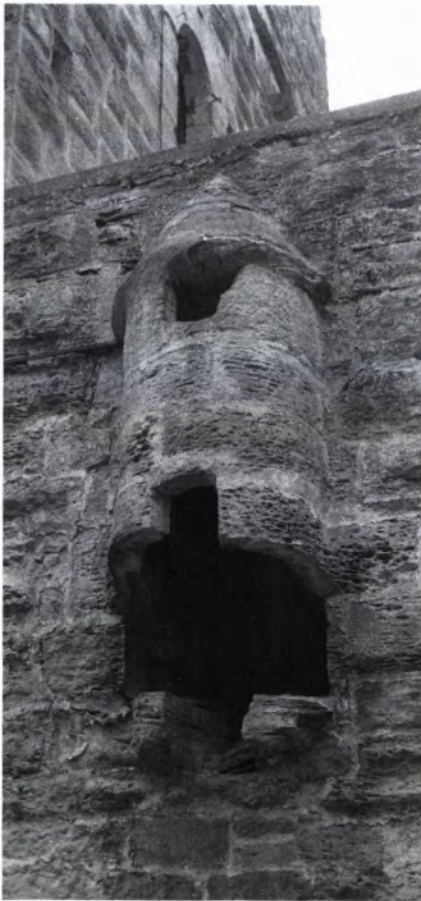
■ 15 Aborterker, Schadensbild. Foto 1996, LDA.
