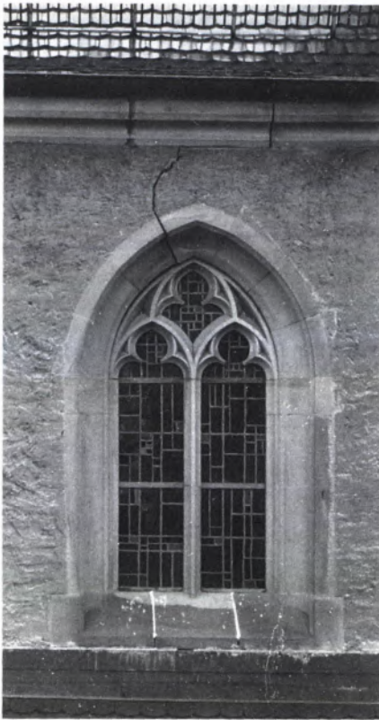
■ 13 Nordseite, Obergaden von Westen. Risse über dem Fenster und im Traufgesims. Photogrammetrische Aufnahme November 1991.
