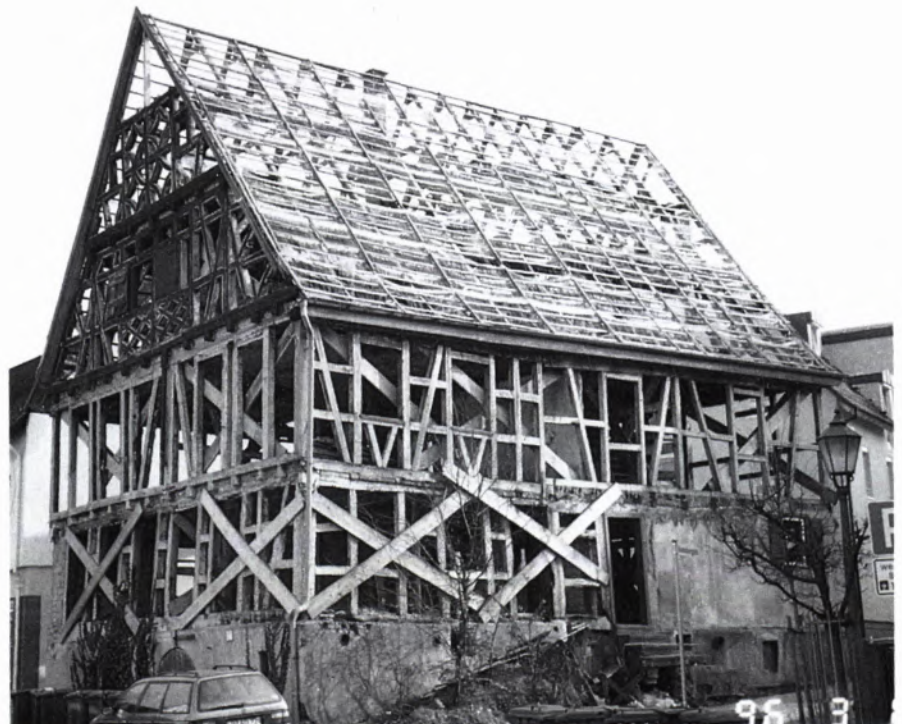
■ 22 Pleidelsheim, das ruinierte Zierfachwerkhaus Hindenburgplatz 2 von 1569, Zustand 1996.
