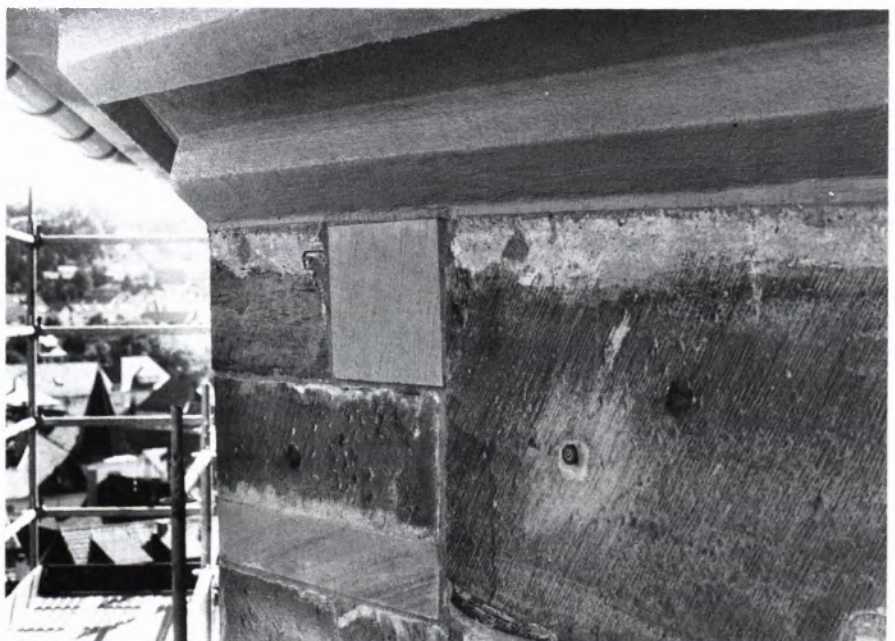
■ 17 Aufnahme während der Sanierungsarbeiten unterhalb des Turmumganges. Die Betonsanierung am Kranzgesims ist abgeschlossen. Darunter mußte ein Stein ausgetauscht werden. In der Mitte des großen Steines befindet sich eine Meßmarke für die Neigungsbeobachtung.
