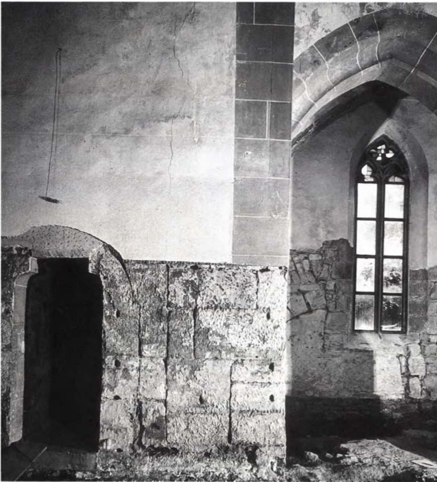
■ 9 Nordansicht Südturm in der Kirche, photogrammetrische Aufnahme 1973. Der Riß im Verputz weist auf eine Verlängerung der Bau-naht zwischen Tür und westlicher Ecke hin. Über der Tür ist nach 1973 ein neuer Riß entstanden (Institut für Architekturgeschichte, G. Nagel).
