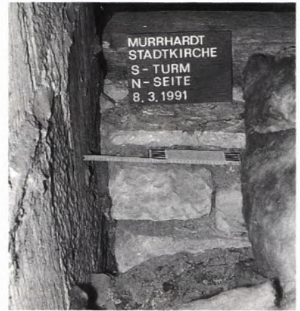
■ 6 Ablösung des Südturms vom Triumphbogen über dem Gewölbe.
