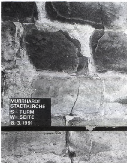
■ 7 Rißverlauf durch die Steine an der westlichen Innenwand des Südturms.
