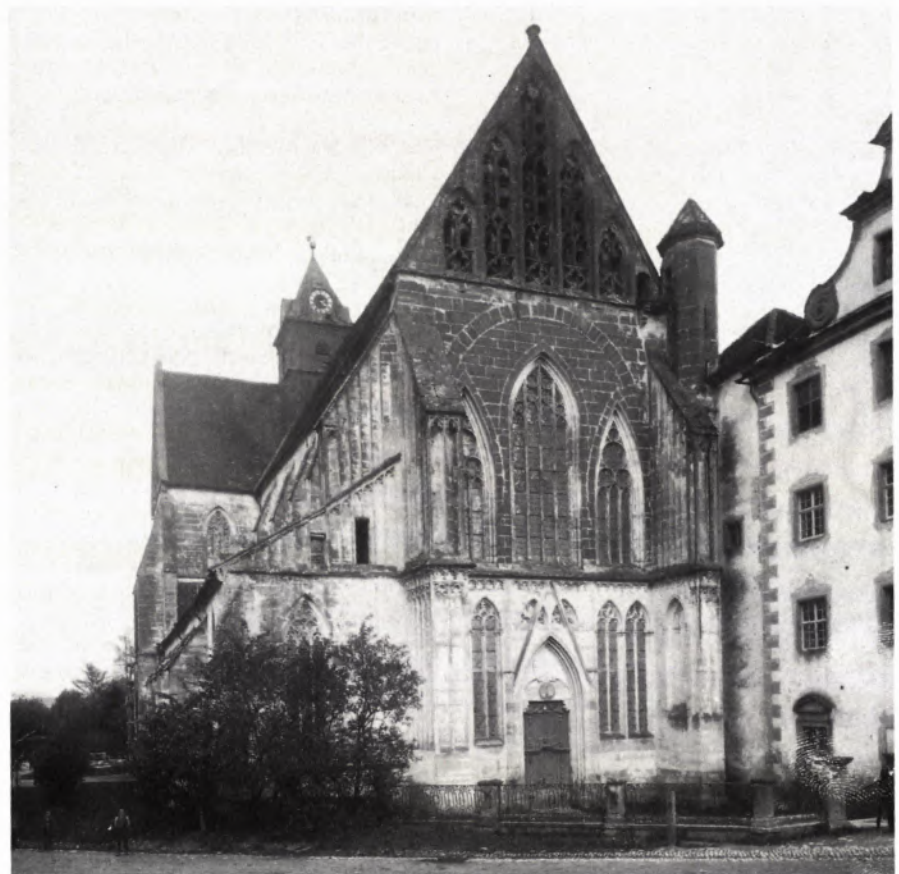
■ 1 Salem, Münster. Ansicht der Kirche von Nordwest aus dem Jahr 1885. Auf der von German Wolf angefertigten Photographie sind sehr gut die Schäden an den Strebpfeilern zu erkennen. Am nördlichen Chorumgang sind die Restaurierungsarbeiten bereits im Gange.
