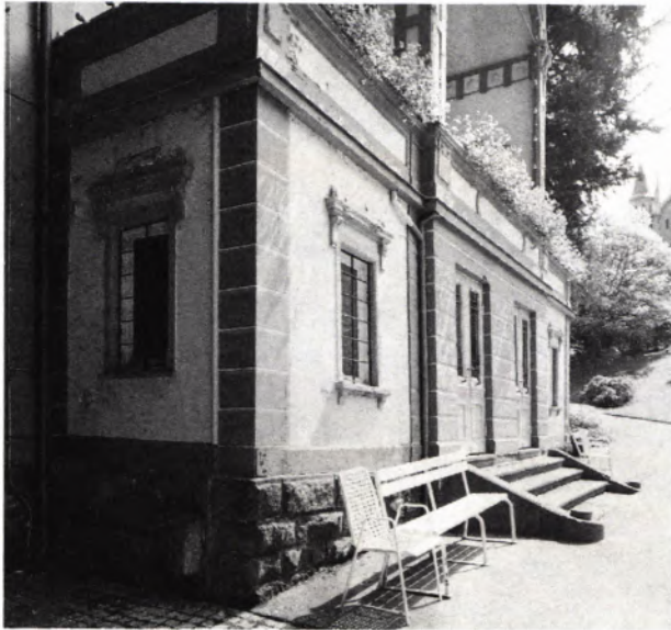
8 SCHRÄGBLICK auf den Eingangsbereich. Deutlich sind die verschiedenen Schadensbilder zu erkennen.
