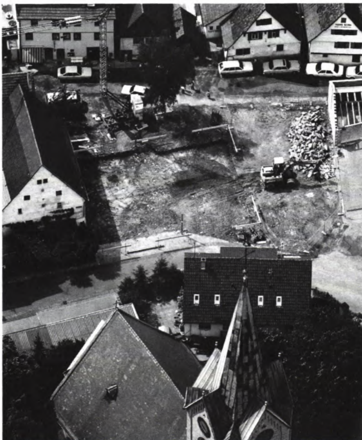
1 BLICK in die Baugrube hinter der Kirche von Renningen, Kr. Böblingen, am 7. 6. 1989. A.-Nr.: 7318/002 B; S 943, 13; 7. 6. 1989.
