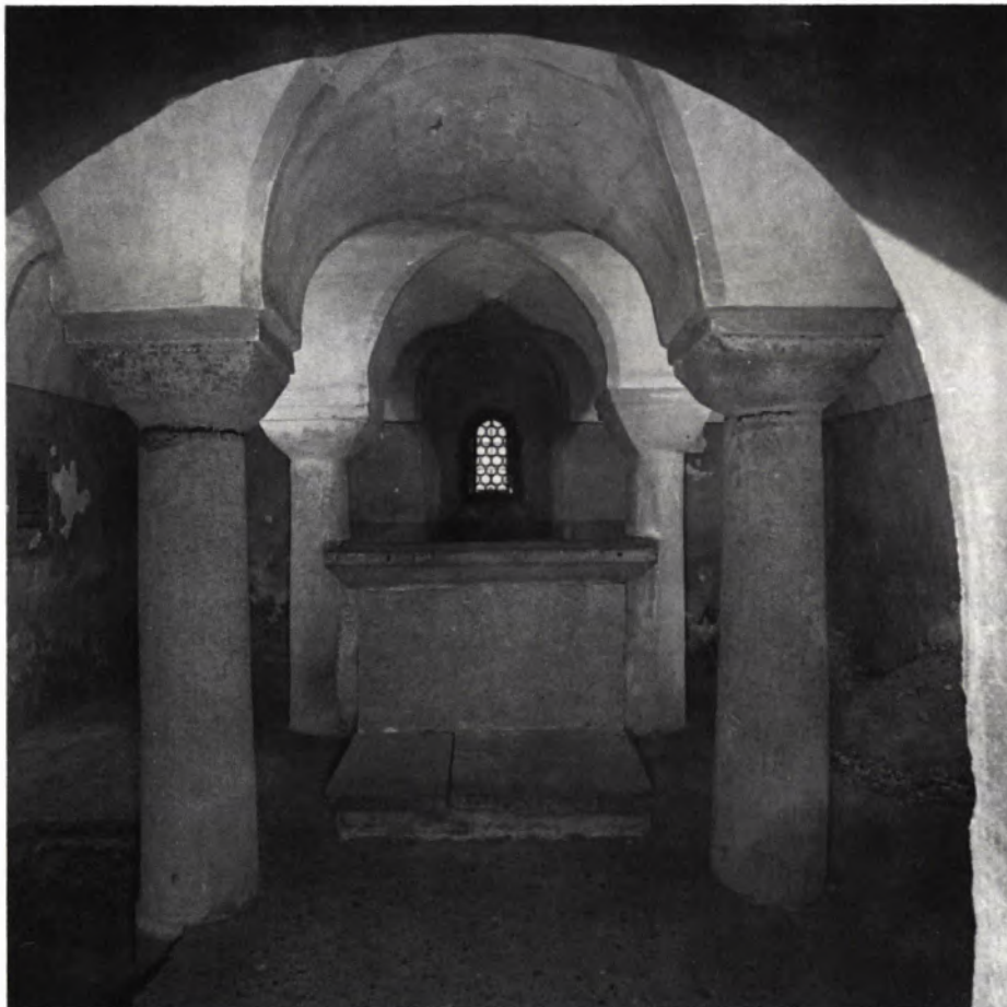
7 ZUSTAND der Krypta vor der aktuellen Restaurierung. Zwischen den Stützen der später eingebaute Altar, links die archäologische Sondierung 1974, an der Wand moderne Tafel mit Reliquienverzeichnis.
