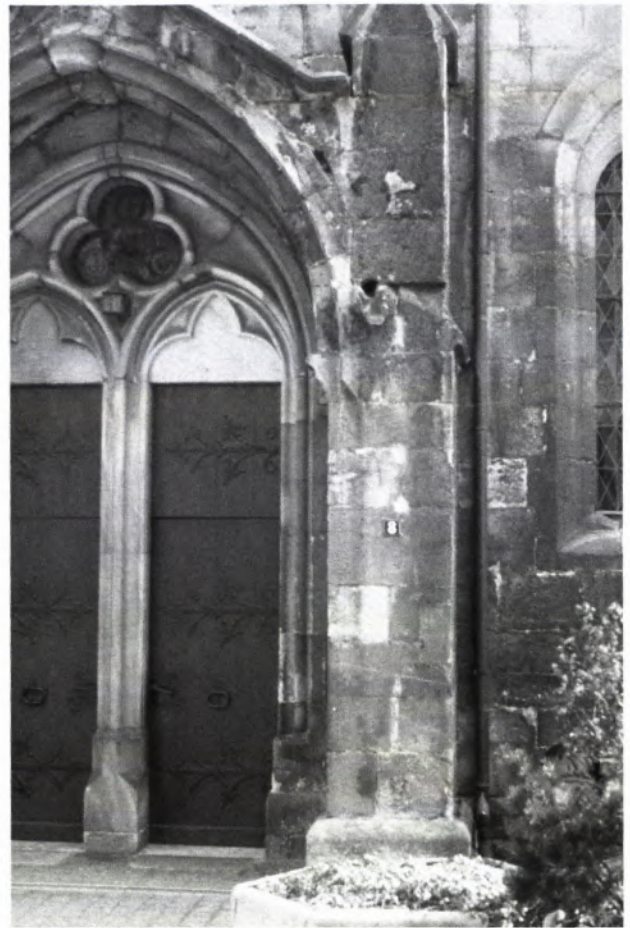
8 ESSLINGEN, Münster St. Paul. Sehr starke Verschmutzung und Krustenbildungen auf Schilfsandstein. Unter den Schmutzkrusten sind teilweise hohe Gipsanteile und tiefreichende Auflösungen zu beobachten.
