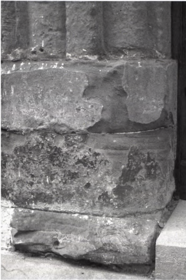
10 KUCHEN, Kreis Göppingen, Evangelische Pfarrkirche. Die Aufnahme zeigt im oberen Bereich vermutlich einen Schilfsandstein, als Sockel wurde wahrscheinlich ein lokaler Sandstein des Braunen Jura verwendet. Der Stein im Sockelbereich zeigt ein starkes Absanden und oberflächenparallele Abblätterungen. Die sedimentär bedingte lagige Struktur wird durch die Verwitterung herausgearbeitet.
