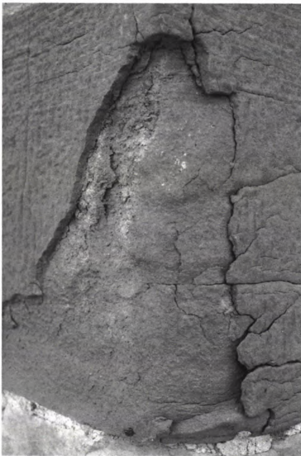
6 REICHENAU-MITTELZELL, Kreis Konstanz, Münster St. Markus. Starke Schalenbildung an einem Eckquader aus rotem Sandstein. Das Schadensbild besteht nicht nur aus oberflächenparallelen Abplatzungen, sondern auch aus horizontalen Rissen und Ausblühungen unter den abfallenden Schalen.
