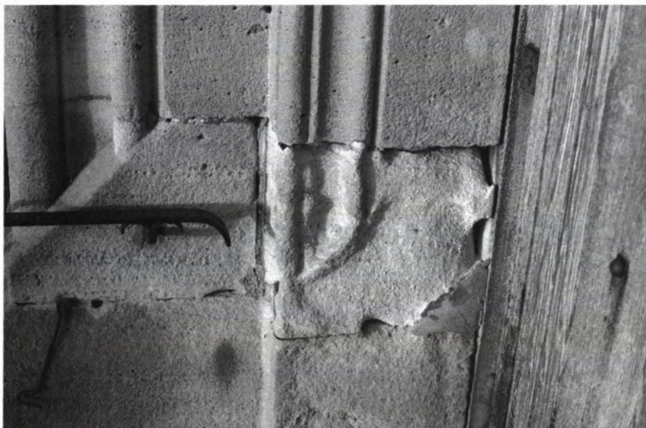
9 AIXHEIM, Kreis Tuttlingen, Katholische Kirche. Innerhalb eines relativ gut erhaltenen Mauerwerksverbandes aus Sandstein zeigen einzelne Steine ein tiefgreifendes Absanden und Aushöhungen. Diese unterschiedlichen Gesteinszustände müssen auch unterschiedlich behandelt werden.
