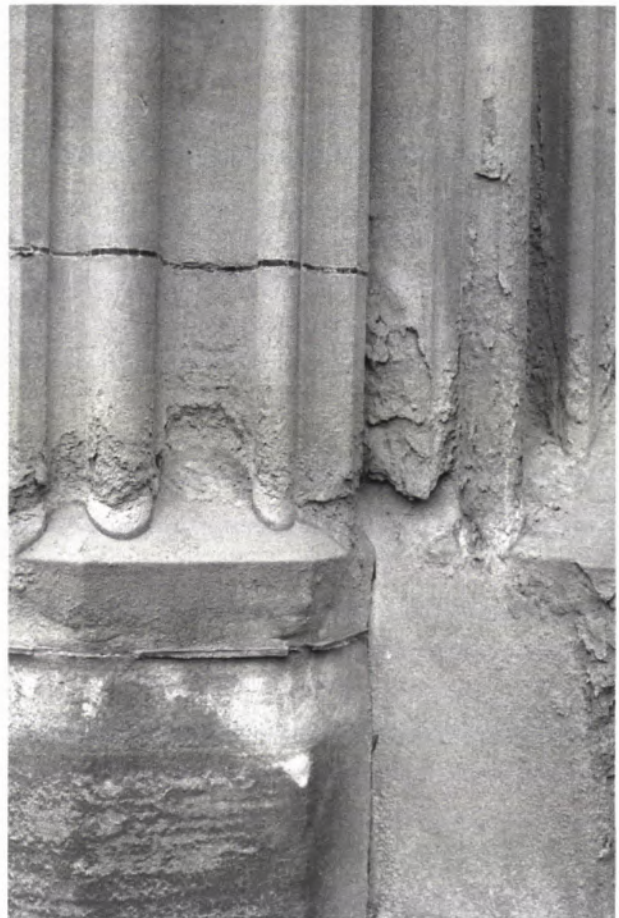
1 SALEM, Bodenseekreis, Münster, Nordquerhaus. Besonders starke Schäden an Basen von Rundstäben eines Fenstergewändes. Die geschädigten Bereiche sind bedeckt von Ausblühungen und zerfallen in Form von kleinen Schuppen.
