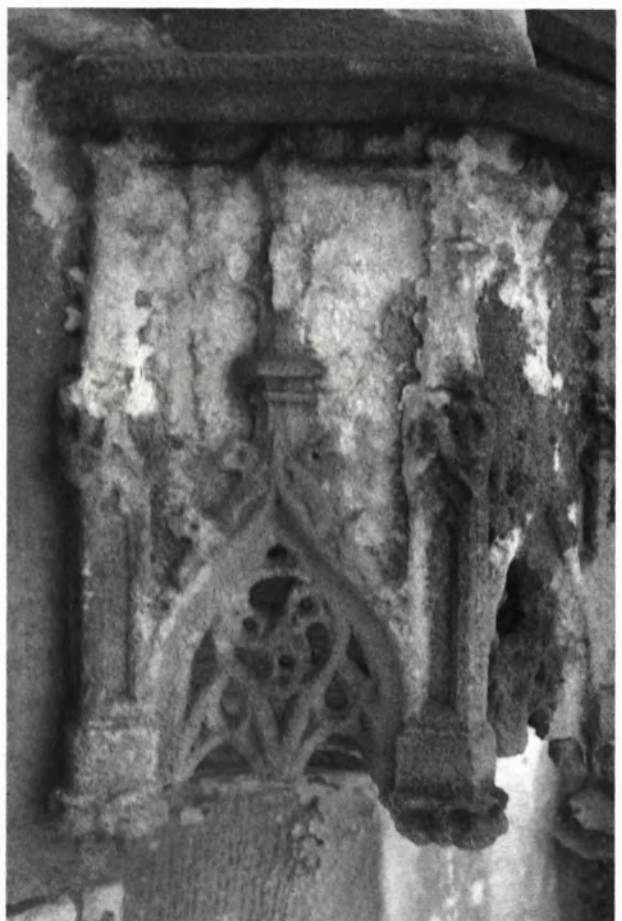
7 GÖPPINGEN, Oberhofenkirche. Feingliederiger gotischer Baldachin neben dem Hauptportal der Kirche. Der Sandstein ist durch Ausblühungen und starkes Absanden fast bis zur Unkenntlichkeit zerstört. Daneben zeigt er an zahlreichen Stellen dicke Schmutzkrusten.
