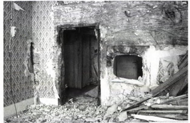
7 ESSLINGEN, Ottilienplatz 9 (1402 d), in Bohlenwand eingeschnittene Hinterladeröffnung für Kachelofen.
