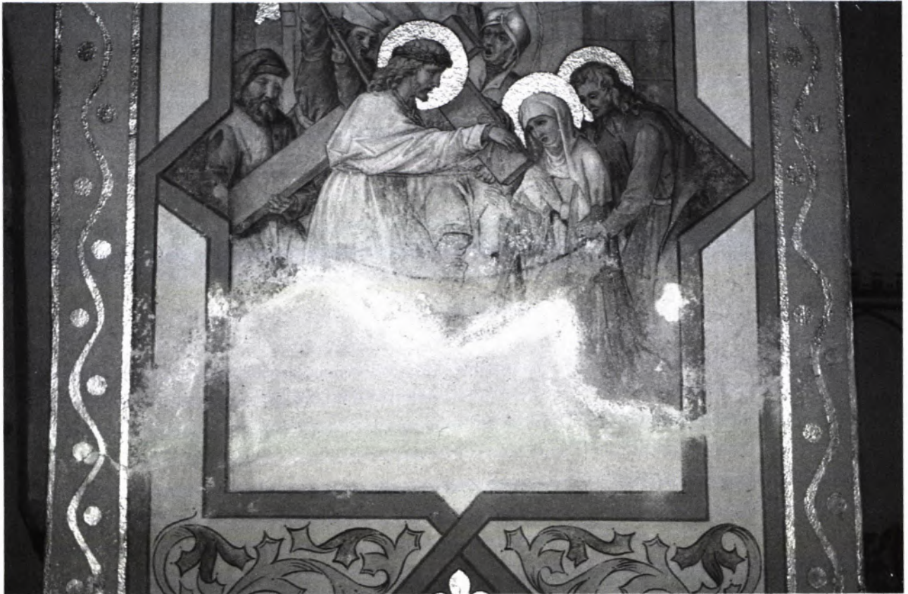
1 AUFSTEIGENDE SALZE haben die Malschicht in Sockelhöhe bereits zerstört...
