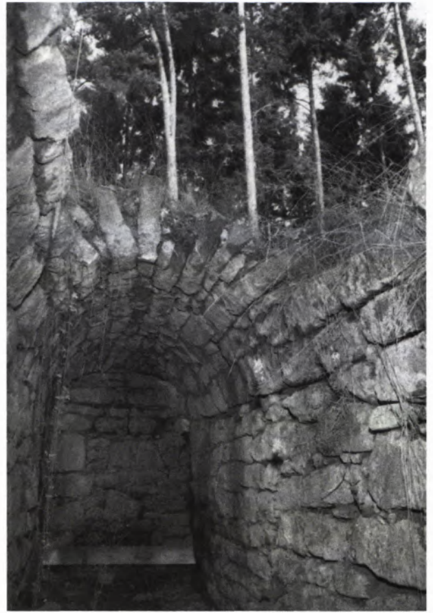
4 GEWÖLBE vor der Sanierung von 1986.
