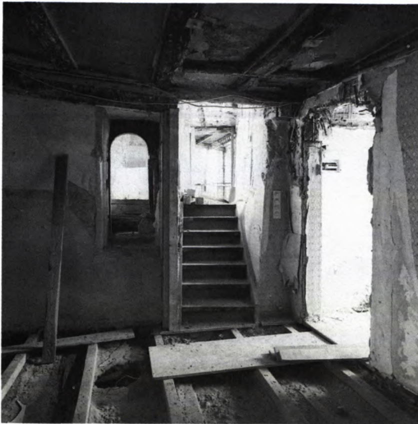
14 BLICK von innen auf die Westwand des Steinhauses im 1. Obergeschoß mit der Treppe zum Durchfahrtsbau (Nr. 3) und dem romanischen Fenster.
