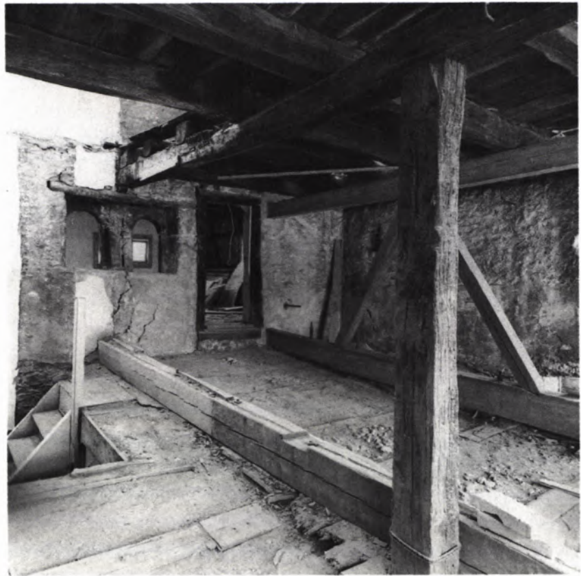
16 INNENANSICHT der Südwand des Steinhauses im 2. Obergeschoß mit Durchgang zum Fachwerkwohnhaus (Nr. 1) und dem gekuppelten Fenster (nach dessen Öffnung).
