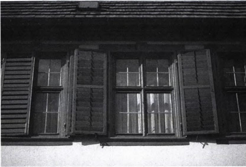
10 DIE REPARIERTEN barocken Kreuzstockfenster bilden wieder eine Einheit mit den alten Klappläden.
