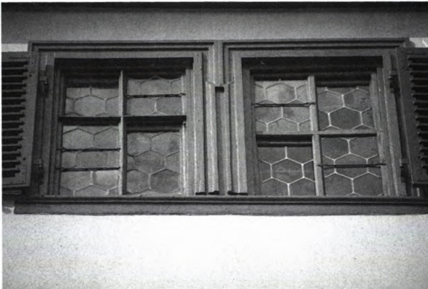
11 DIE SCHIEBEFENSTER im Dachgeschoß waren ohne Scheu unterschiedlich aufgeteilt worden, gleichzeitig mit den Drehflügel Fenstern der „Beletage“.
