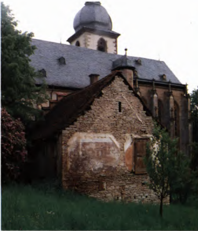
Zum Ensemble der Bergkirche in Weikersheim-Laudenbach gehörend und darüber hinaus als seltenes Beispiel eines nicht herrschaftlichen zweistöckigen Massivbaus, ist die Erhaltung des 1605 erbauten Mesnerhauses eine wichtige denkmalpflegerische Aufgabe.
