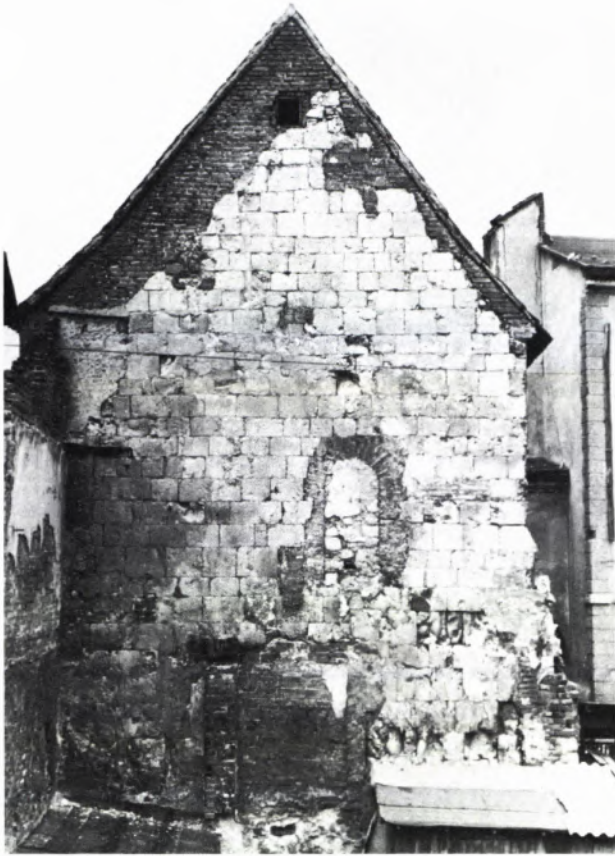
7 SPÄTROMANISCHE Westwand des Steinhauses mit stark beschädigtem Quadermauerwerk (Zustand 1963).
