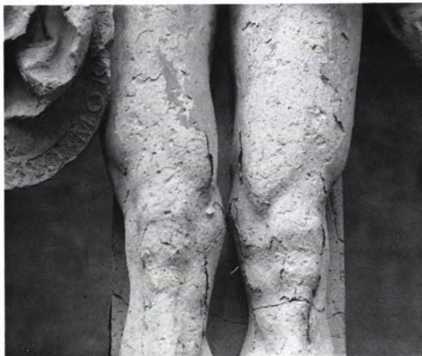
12 BAD WIMPFEN, Kreuzigungsgruppe, 1982 aufgenommenes Detail der Beine Christi. In kaum mehr als 50 Jahren sind große Teile der subtil gestalteten Oberfläche zerstört worden. Der noch vorhandene Originalbestand hat sich an vielen Stellen als dünne Schicht vom Untergrund abgesetzt. Nach dem Verlust der vom Bildhauer bearbeiteten Oberfläche bröckelt der Tuff in kleinen Schollen ab. In diesem Zustand führen bereits Witterungseinflüsse, die für gesunden Stein völlig harmlos wären, zu weiteren schweren Substanzverlusten.
