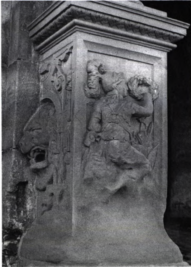
15 TÜBINGEN, Detail des unteren Schloßportals, Säulenpostament neben dem Torbogen; Foto 1983. Basisprofil und unteres Drittel des Reliefs sind völlig zerstört. Der Stein löst sich in abrießendem Sand auf. Der Schaden ist in diesem Fall, anscheinend verursacht durch Spritzwasser mit Streusalz, in extrem kurzer Zeit eingetreten: Das Säulenpostament gehört nicht zum Originalbestand des 1606/07 errichteten Portals, sondern es wurde erst vor ca. 30 Jahren als Kopie angefertigt. Auch zum ursprünglichen Bestand gehörende Teile des unteren Schloßportals zeigen gravierende Schäden. Durch alte Fotos läßt sich belegen, daß heute stark angegriffene oder zerstörte Details zu Beginn des 20. Jh. noch intakt waren.
