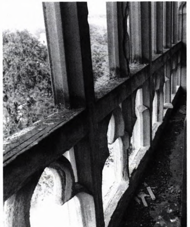
16 SALEM, Kirche des ehem. Zisterzienserklosters, Detail des Giebelmaßwerkes an der nördlichen Querhausfassade; Foto 1983. Der Kirchenbau wurde 1299 begonnen, die Nordfassade entstand um 1320/30. Eine umfassende Restaurierung, bei der auch das Giebelmaßwerk der nördlichen Querhausfront erneuert wurde, ist gegen Ende des 19. Jh. ausgeführt worden. Aufspaltungen des Sandsteines, abgesprengte Schalen der Oberfläche und geschwächte Brüstungspfosten mit losem Steingefüge stellen eine starke Gefährdung für den gesamten Maßwerkbestand dar.
