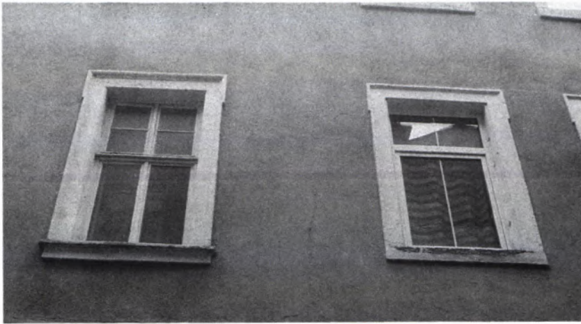
2 ALTES UND NEUES FENSTER: Links ein altes Fenster, das aber bereits in früherer Zeit die unteren 2x2 Spro- ssen verloren hat, rechts ein neues Kunst- stofffenster. Aufnahme 1984 in der Hei- delberger Hauptstraße.
