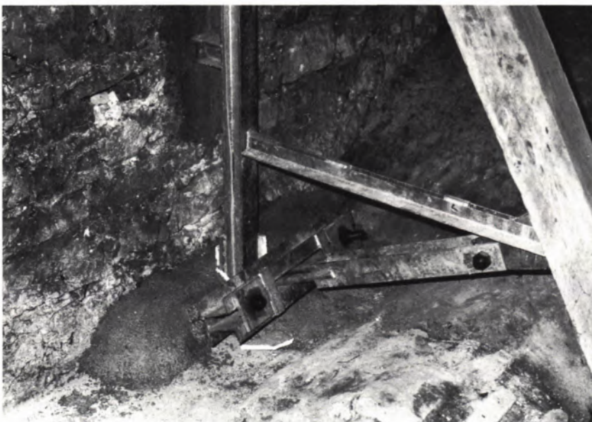
22 VERANKERUNG des Zugbinders über den Gewölbebogen. Über die beiden Schrauben am Gewölbeanfang wurde der Stahlbinder in zeitlich versetzten Etappen vorgespannt.
