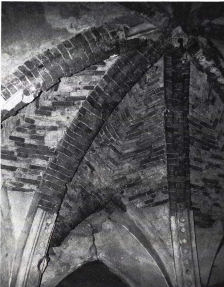
12 SCHADHAFTES GEWÖLBE im Bergfried.
