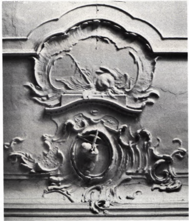
2 VORHER: Mehrfach überfaßte Stuckflächen im Inneren des Neuen Schlosses in Tettnang vor der Freilegung durch den Restaurator.
