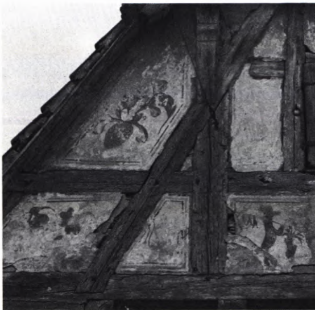
10 „WENGERTER“-HAUS IN HESSIGHEIM, Besigheimer Straße 17. „Alemannisches“ gefäßtes Fachwerk mit Malerei auf den Gefachen.
