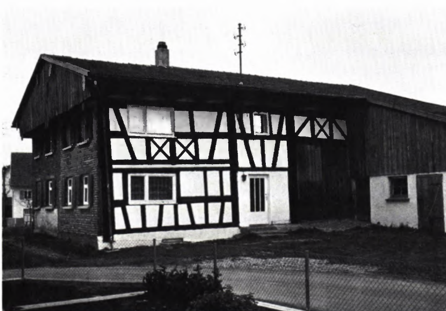
1 und 2 AUSNANG bei Leutkirch im Allgäu, Kreis Ravensburg. Fassade des Hauses Nr. 50 um 1920 und 1969: Verunstaltung eines im Denkmaltbuch eingetragenen Kulturdenkmals durch „Modernisierung“. Alle Anfragen des Landesdenkmalamtes bei der zuständigen Baurechtsbehörde blieben unbeantwortet.
