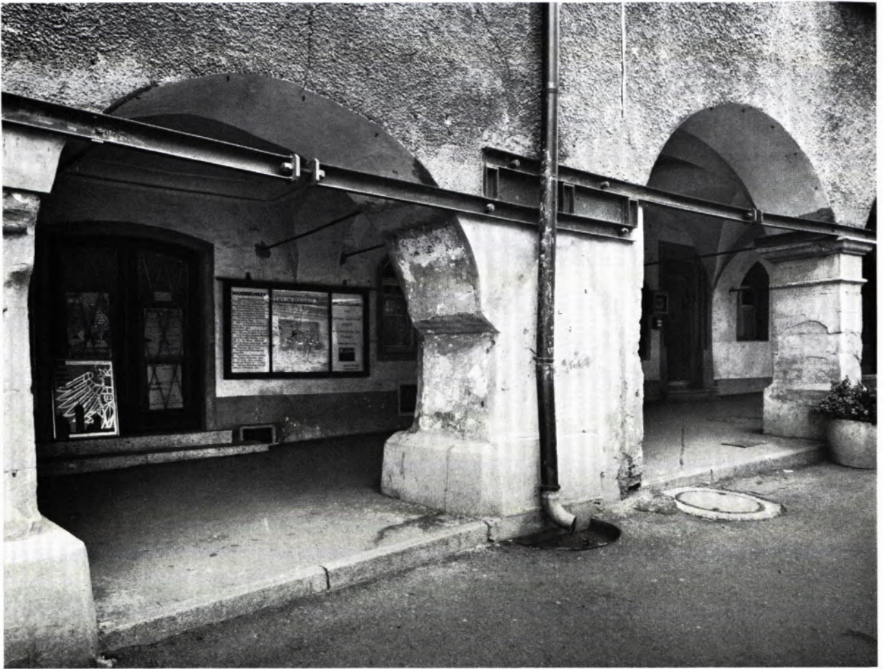
STAHLANKERSICHERUNG IM BEREICH DER ARKADENZONE DES ERDGESCHOSSES. Die unsicheren statischen Verhältnisse des Alten Rathauses machten allerlei Sicherungsmaßnahmen erforderlich, so die Absicherung der straßenseitigen Arkadenzone durch eine Zugankerkonstruktion.
