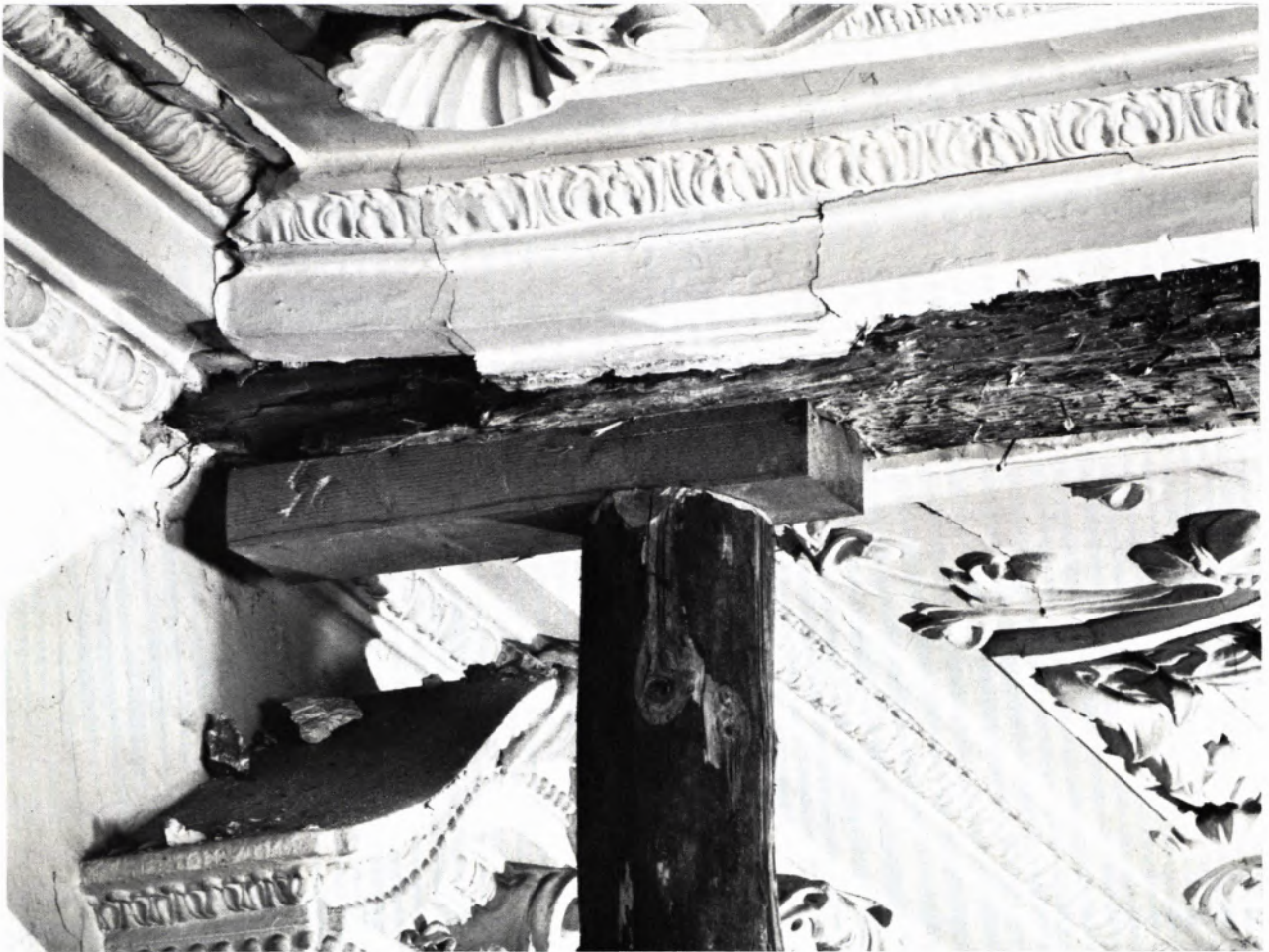
BAUSCHADEN IN DER TREPPENHAUSHALLE DES ZWEITEN OBERGESCHOSSES. An verschiedenen Stellen waren die Balkenunterzüge der Decken an den Kopfseiten verfault und gebrochen. Sie mußten, wie in unserem Beispiel, provisorisch abgestützt werden.
