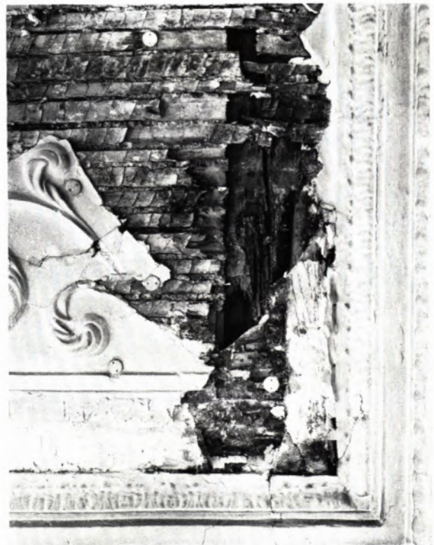
VERFAULTE DECKENBALKEN IM ZWEITEN OBERGESCHOSS. Das Bildbeispiel veranschaulicht den überaus desolaten Zustand, in dem sich das Holzwerk über den reich stuckierten Decken zum größeren Teil befindet. Hier muß Abhilfe geschaffen werden, was bei der erklärten Absicht, die wertvollen Stukkaturen zu erhalten, nur nach der äußerst schwierigen und kostspieligen Abnahme des Stuckbestandes möglich wird. Die dem Laien wahrscheinlich unerklärliche Beilkerbung der Deckenlatten hatte den Sinn, dem Gipsputz der Decke bessere Haftung zu gewähren und zu verhindern, daß das durch Feuchtigkeit bedingte „Arbeiten“ des Holzes sich auf den Putzaufzug übertragen und so zur Rissebildung führen konnte.
