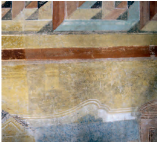
5 Arbeitsprobe im Jahr 2003 zur Abnahme des Schimmelpilzbefalls auf der Nordwand.
