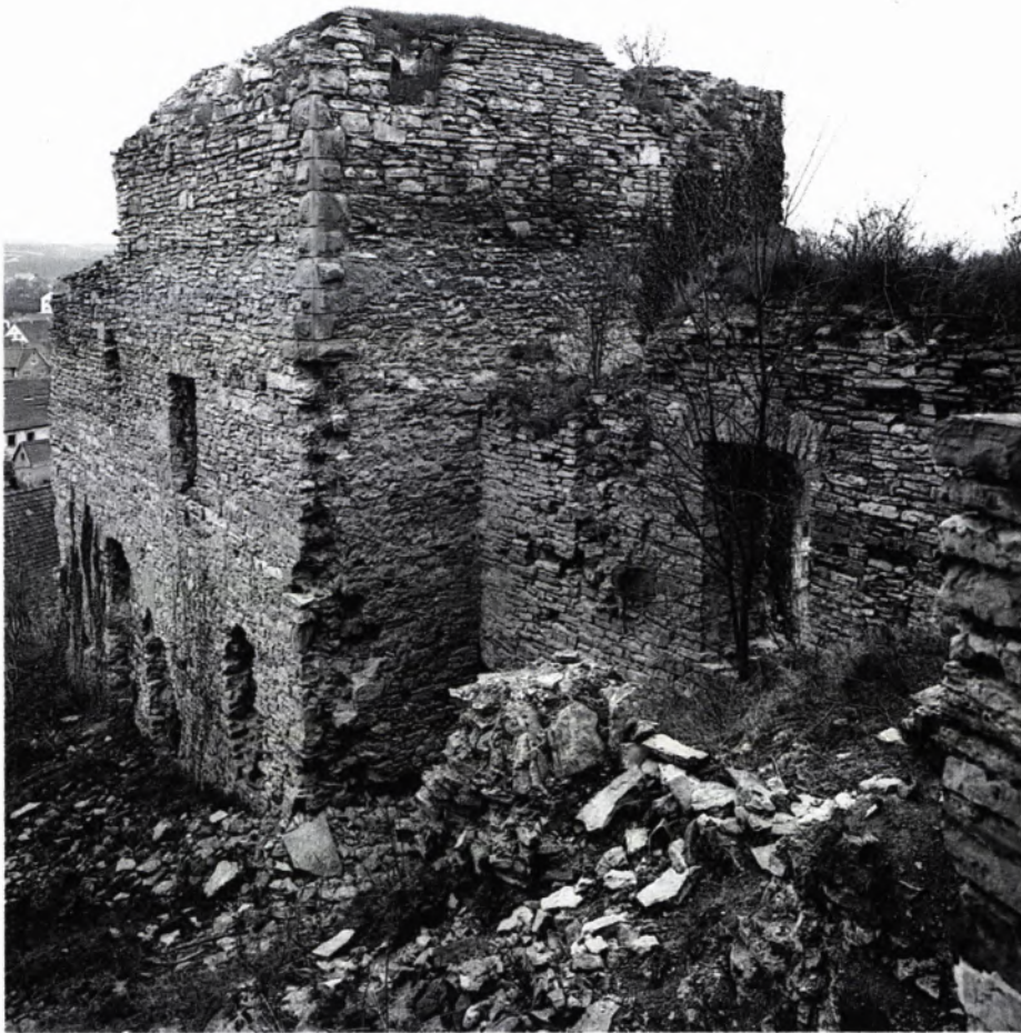
9 ZUZENHAUSEN, Blick auf den Palas. Die Eckquader sind von unten her bis auf eine Höhe von 8 m herausgebrochen, desgleichen fehlen sämtliche Fenster- und Türleibungen. Die im Vordergrund noch sichtbare Mauer löst sich auf und dürfte in wenigen Jahren nicht mehr erkennbar sein.
