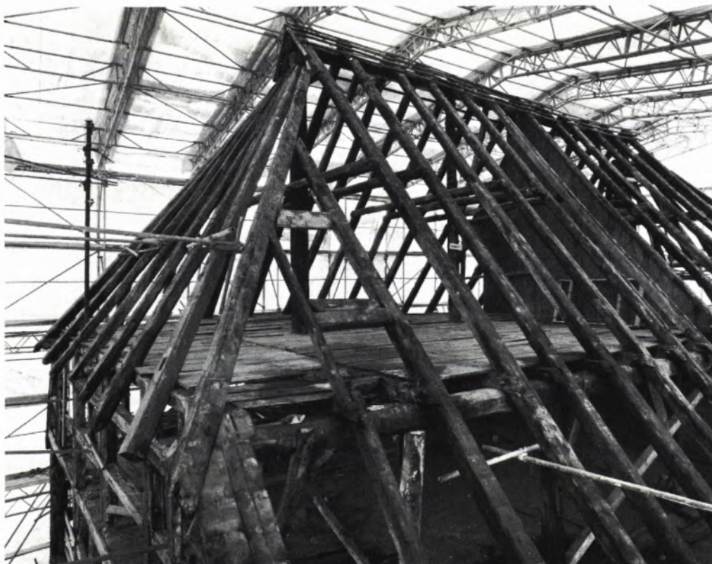
6 DACHKONSTRUKTION während der Instandsetzung nach Abnahme der Dachdeckung. Die Sparren des Hauptdaches sind im Bereich des Walmes an den Gratsparren angeschifft, die radial angeordneten Sparren des Halbwalmes laufen dagegen in voller Länge bis zu ihrer Auflage am „Hahnenbalken“. Bedingt durch die konstruktive Ausbildung der unteren Auflagen der Sparren ist kein Aufschiebling erforderlich.
