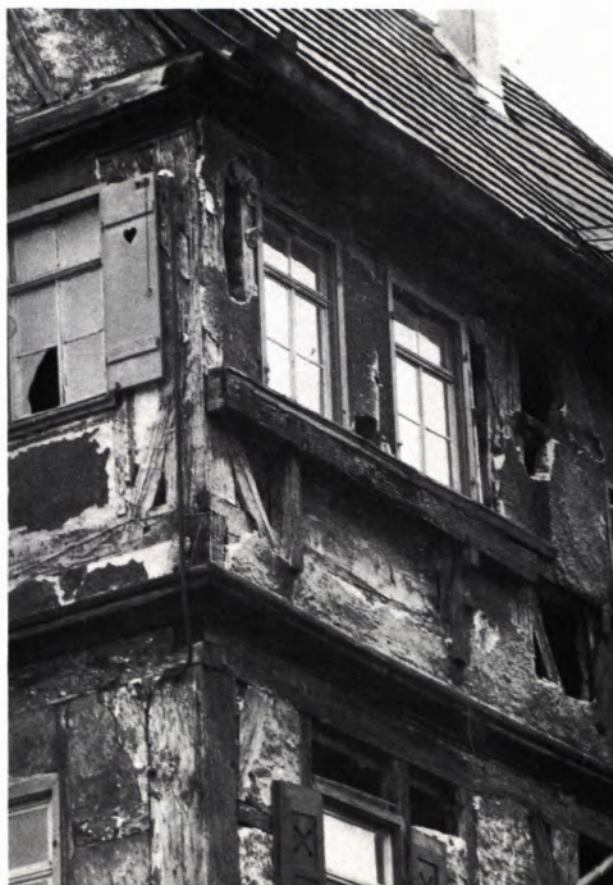
2 GEBÄUDEECKE bei Beginn der Untersuchungen.
