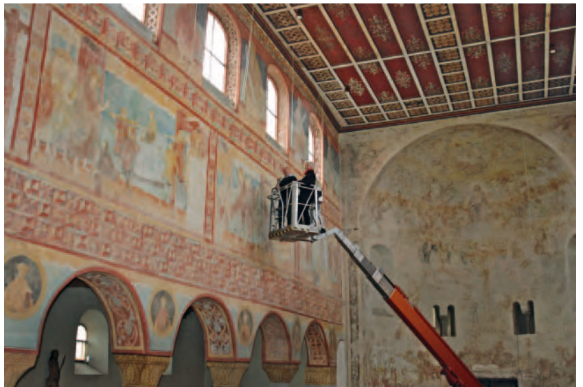
Untersuchungen in St. Georg auf der Reichenau durch das Landesamt für Denkmalpflege.
