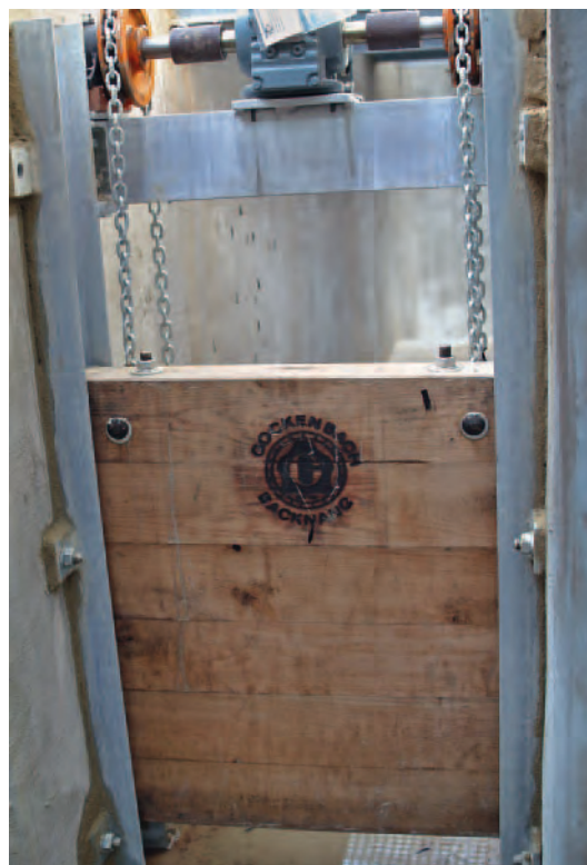
5 Neu gelagerter Schieber im Vorfluter zum Bypass.
