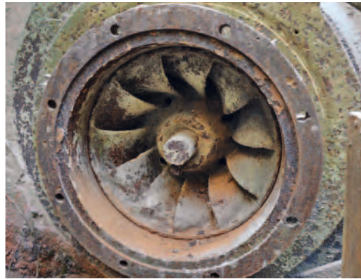
4 Das Turbinenrad zeigt im Vorzustand starke Korrosion und Kalkablagerungen.
