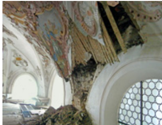
11 Abgang der Stuckierung oberhalb eines Kapitells an der Chorwestseite.
