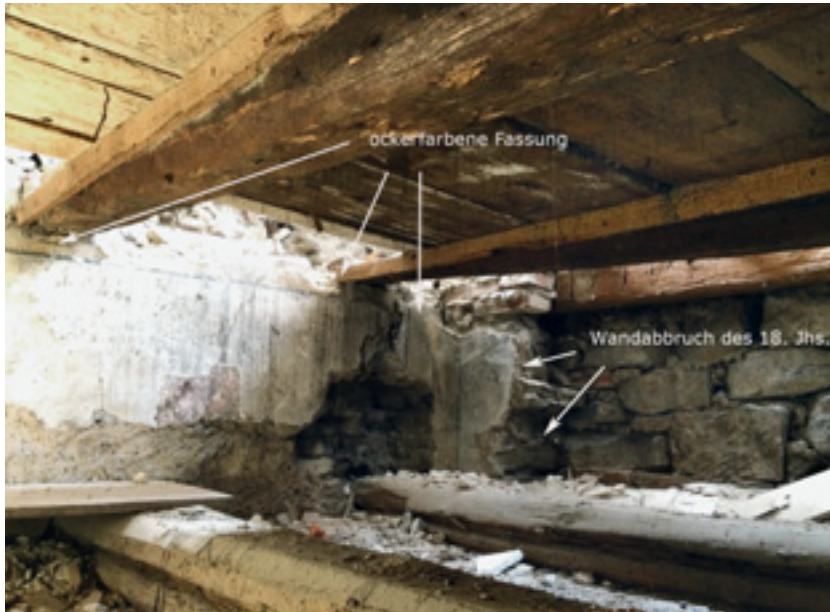
4 Bereich zwischen den beiden Decken im Nordwestraum am Übergang der Westwand zur Nordwand mit Befunden zur bauzeitlichen Ausmalung und der letzten Raumfassung vor Einbau der Barockdecke.
