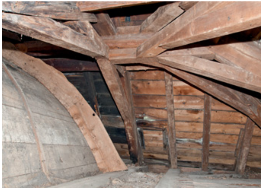
7 Eckverbindung der Rähm auf Kehlbalkenlage, durch Metallverbindungen und Zugstangen verstärkt.
