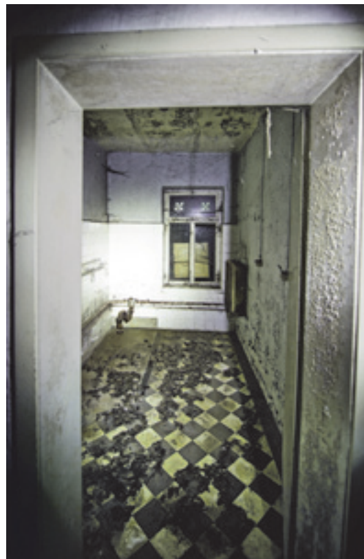
4 Blick in eine Badezelle vor der Sanierung, am Sockel in der linken hinteren Ecke ist noch der Standort der Badewanne zu erkennen.
