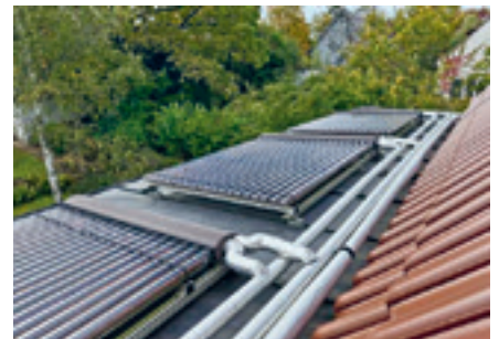
6 Solarthermie auf dem angeschleppten Süddach eines Wohnhauses.
