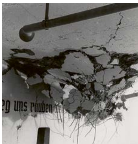
7 Historischer Deckenabsturz im Tiefbunker E6, 4–6.
