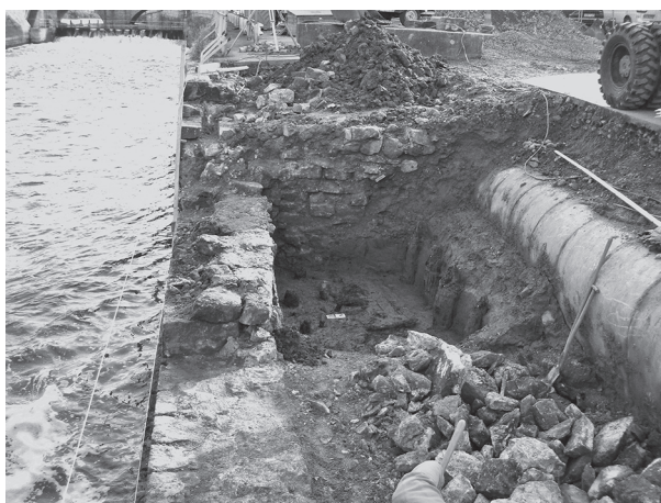
Abb. 238 Münden FStNr. 175, Gde. Stadt Hann. Münden, Ldkr. Göttingen (Kat.Nr. 288) Bauarbeiten an der Werraschlagdmauer. (Foto: A. Demandt)
