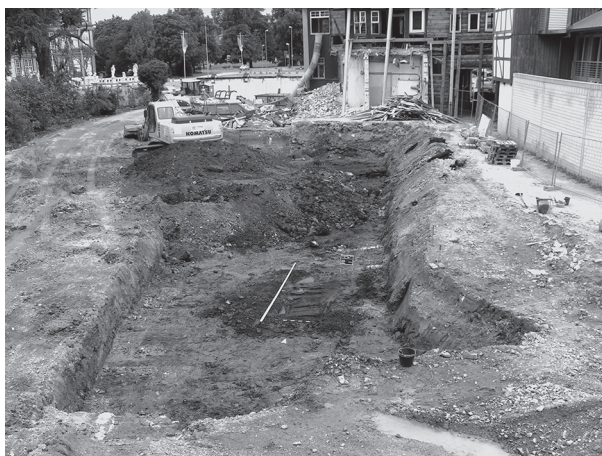
Abb. 274 Wolfenbüttel FStNr. 60, Gde. Stadt Wolfenbüttel, Ldkr. Wolfenbüttel (Kat.Nr. 323) Detail des Knüppelweges auf dem Boden der Baugrube, von Süden. (Foto: J. Weber)
