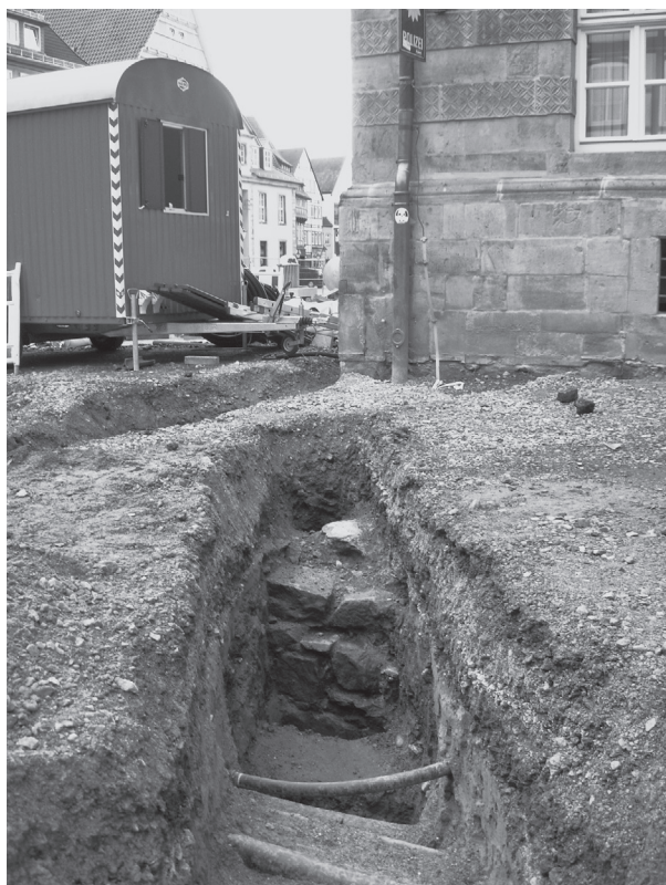
Abb. 98 Hameln FStNr. 180, Gde. Stadt Hameln, Ldkr. Hameln-Pyrmont (Kat.Nr. 117) Mittelalterliches Bruchsteinfundament im Leitungsgraben s des Hochzeitshauses. Blick gegen NW. (Foto: J. Schween)
