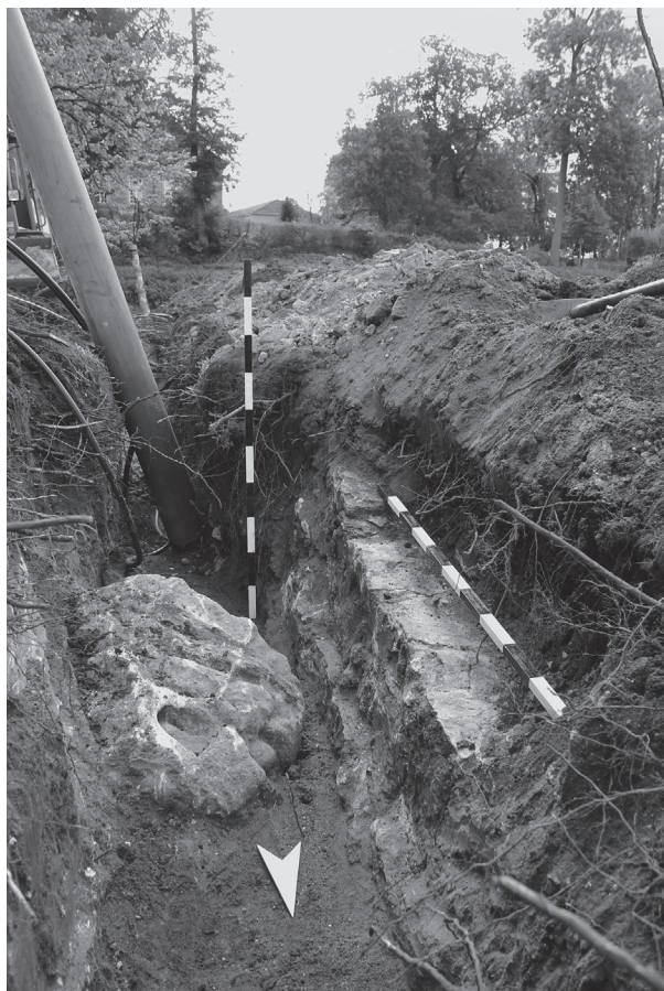
Abb. 109 Neustadt a. Rbge. FStNr. 23, Gde. Stadt Neustadt a. Rbge., Region Hannover (Kat.Nr. 133) Bruchsteinfundament und mit Mörtel überzogener Findling im nördlichen Vorgelände des Schlosses Landestrost. (Foto: J. Schween)
