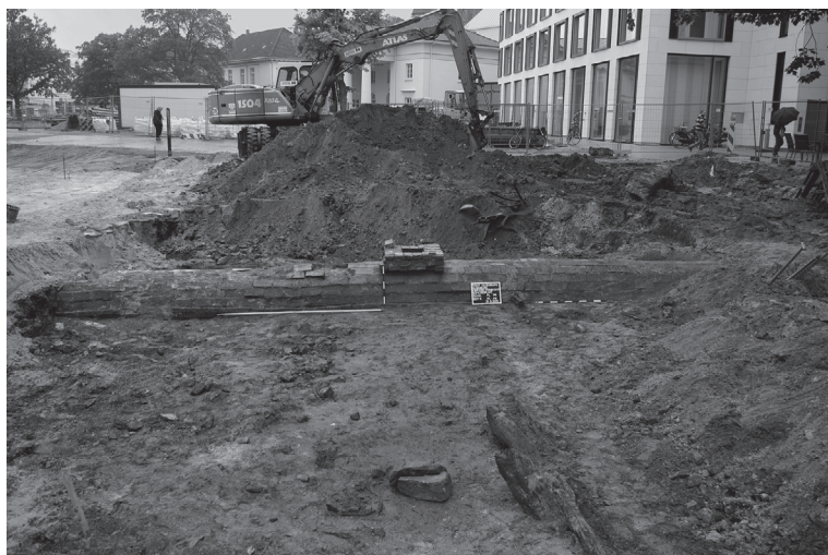
Abb. 186 Oldenburg FStNr. 117, Gde. Stadt Oldenburg, KfSt. Oldenburg (Kat.Nr. 263B) Einer der Abwasserkanäle (mit aufgesetztem Revisionschacht) – Blick von Osten. (Foto: P. Weiler)
