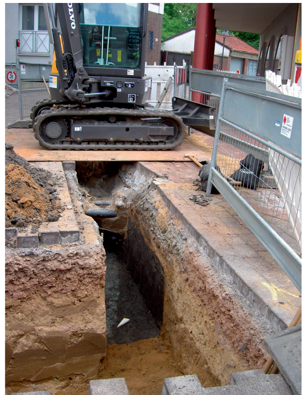
Abb. 201 Peine FStNr. 136, Gde. Stadt Peine, Ldkr. Peine (Kat.Nr. 302). Im Leitungsgaben Ecke Bodenstedtstraße/Pulverturmwall wird deutlich, dass der dunkel verfüllte mittelalterliche Stadtgraben hier abwinkelt und der im Hintergrund sichtbaren Flucht der Gasse Pulverturmwall folgt. Aufnahme von NNW. (Foto: T. Budde)
