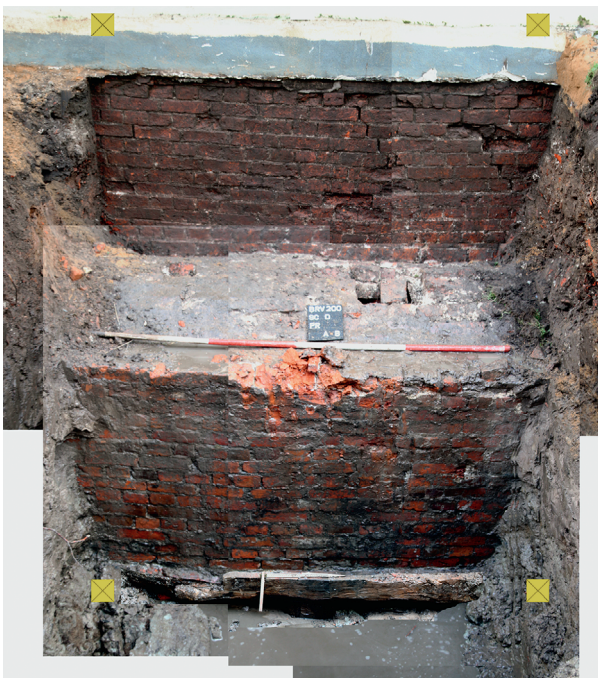
Abb. 207 Bremervörde FStNr. 200, Gde. Stadt Bremervörde, Ldkr. Rotenburg (Wümme) (Kat.Nr. 307). Abwasserkanal mit darunter liegender Pfahlrost-Konstruktion am Kanzleiflügel des Bremervörder Schlosses. (Foto: I. Neumann)
